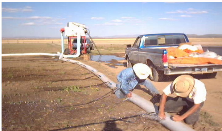
Figura 1. Sistema de riego por goteo de baja presión (LPS), al inicio de su operación.
